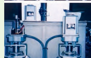
▲汚泥処理送水設備弁
