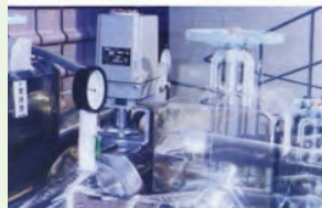
▲大型多目的体育館防災設備
