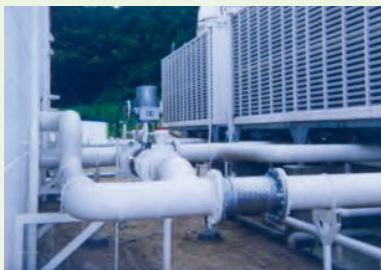
▲ビル空調排水装置制御弁
