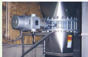
▲工場自動換気設備制御弁
